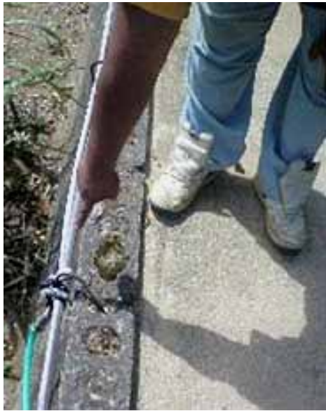
メーターを通さず不正改造とみられるパイプ。 (伊仙町役場提供)
